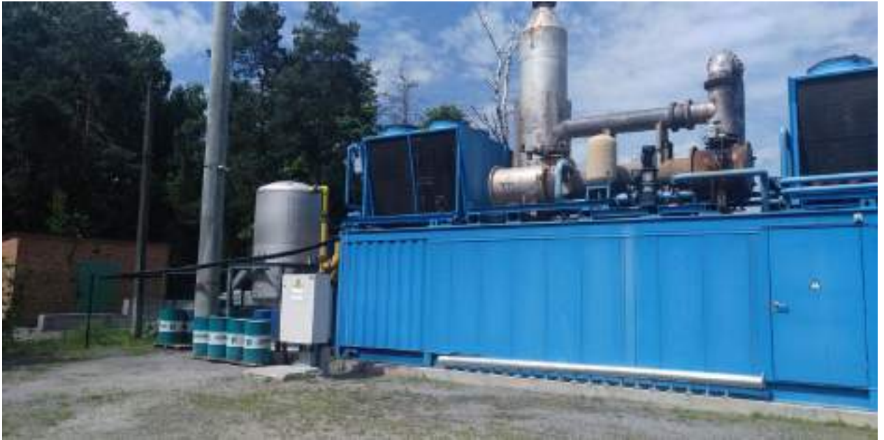
Рис. 4.1. Зовнішній вигляд автоматизованої біогазової установки на Стадницькому полігоні [91]
