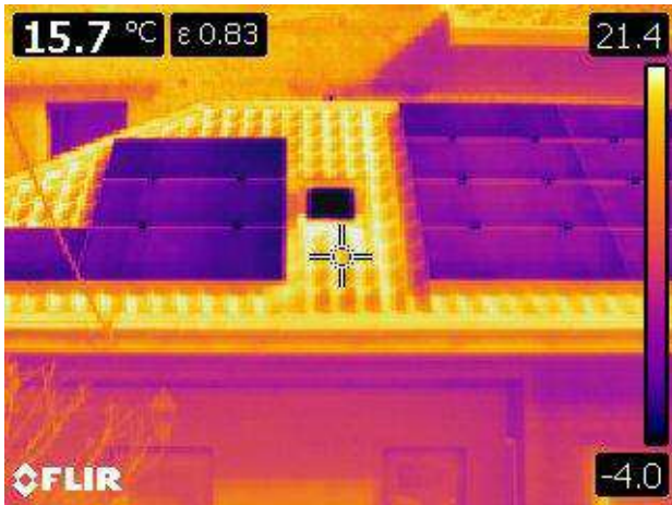
Рис. 5. Фотозображення результатів замірів з тепловізора з фіксацією температурного показника металопрофільної черепиці +15,7 °С. Час спостереження 15.00
